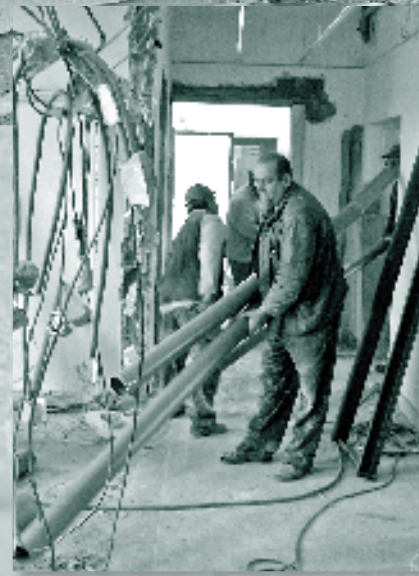
* Práce na rekonštrukcii budúceho Seniorcentra Amico sa dostávajú do svojej záverečnej fázy. Vonkajší vzhľad potrebuje ešte drobné „kozmetické“ úpravy a aj vnútro už dostáva tvar ktorý prezrádza, akému účelu bude slúžiť. Seniorcentrum Amico bude mať k dispozícii 12 lôžok a s jeho otvorením sa ráta začiatkom jari 2006.
